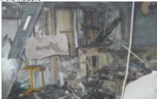
Hình ảnh khu vực bị cháy trong bệnh viện sau sự cố What the hospital ward looked like after the incident
